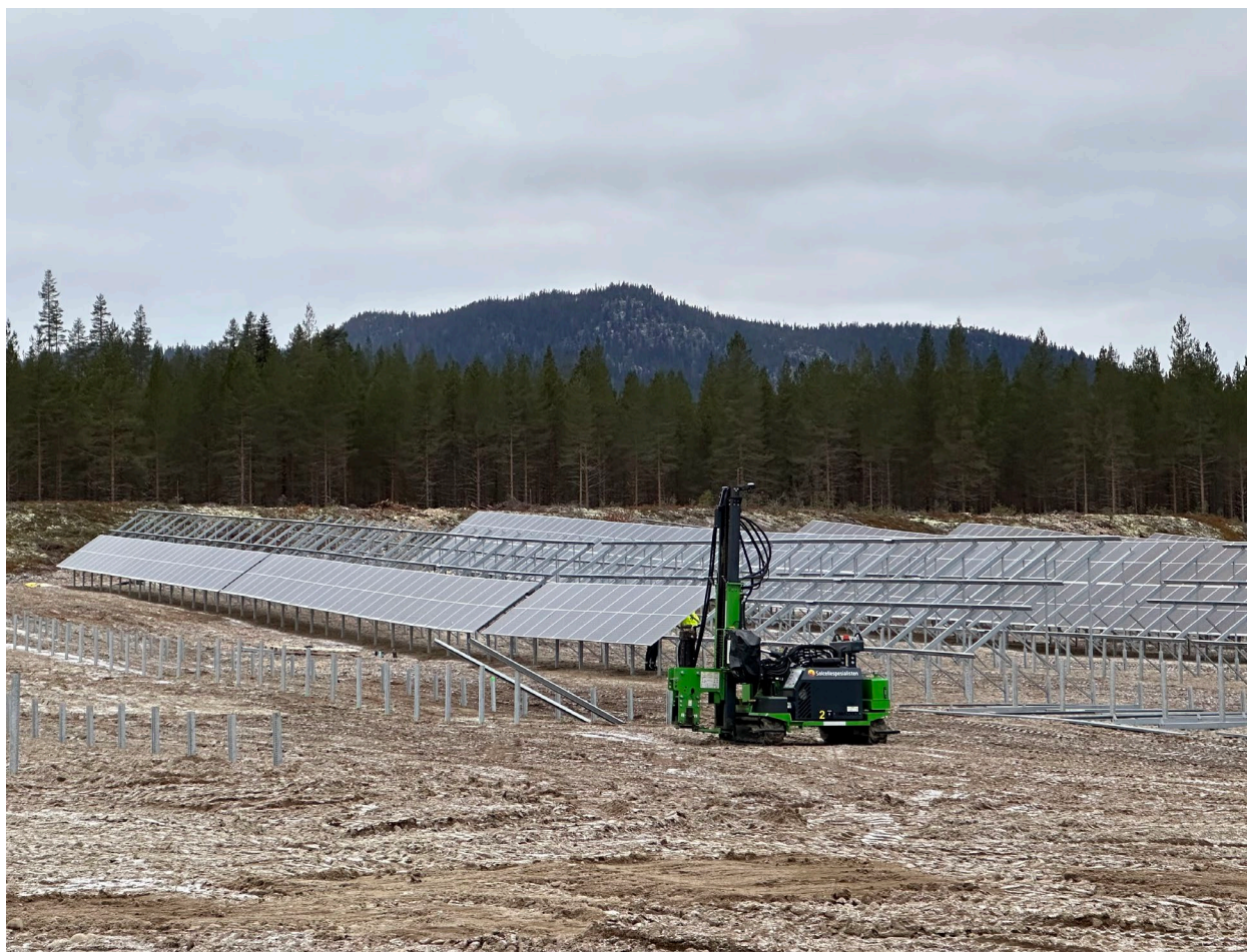
Bilde 3 Tosidige paneler i glass, 580W-605W, Furuseth Solpark Foto: Solcellespesialisten
