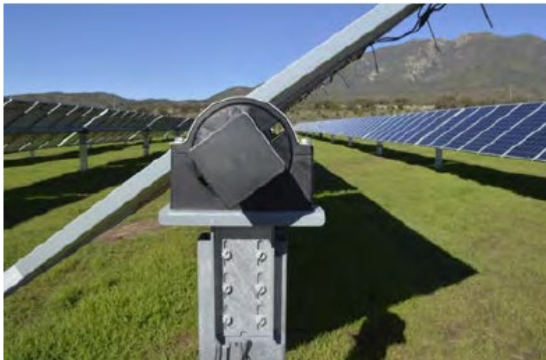
Figur 8: Bilde av solkraftverket som skal etableres i Mæhlum solkraftverk. Solcellepanelene er montert på et stativ med en bevegelig akse som tillater rotasjon med solens gang gjennom dagen. Bildet er hentet fra meldingen som ble sendt til NVE.
