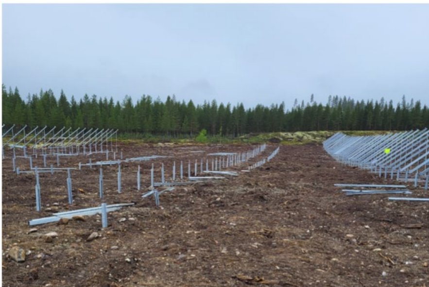
Bilde 3. Solcellestativer under montering i det nordre delområdet. Det forbores før pæling, men stein raser tilbake i borehullet og gjør pælingen svært vanskelig. Stativene blir bøyd og skadet.
