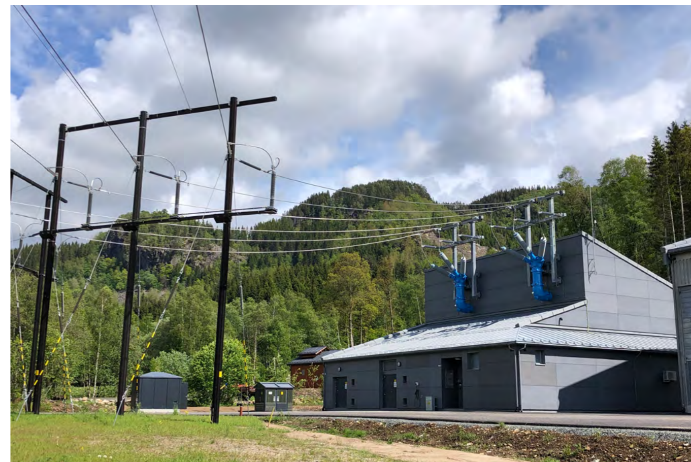
Austerdalen Transformatorstasjon i Kvinesdal er en av transformatorstasjonene som Glitre Nett har bygget med høyspentbrytere uten den klimaskadelige drivhusgassen SF6.
