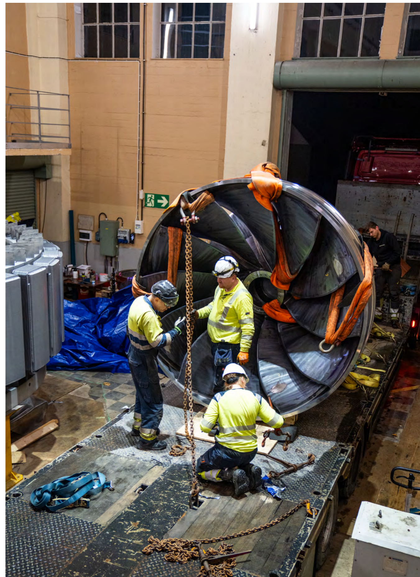
Å Energi oppgraderer Iveland kraftverk for rundt 200 millioner kroner. Det øker produksjonen av ren, fornybar energi fra rundt 500 GWh, til 506 GWh, som gir strøm til om lag 31 600 boliger.
