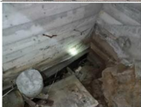
B-167 Stående vann i krypkjeller rom AU50
