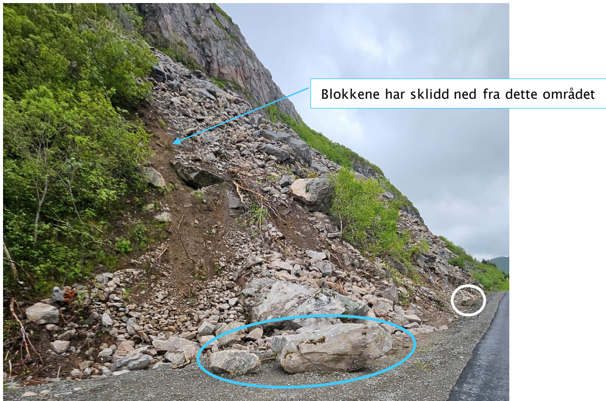
Figur 5: Blokker som har kommet ned i grøft i løpet av juni 2025.
