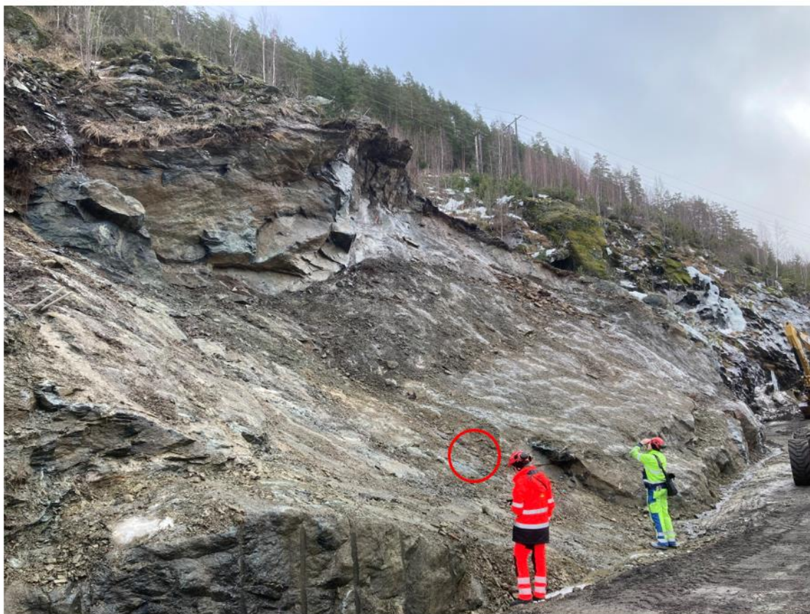
Figur 3-3. Utglidningsflate for skredet den 8.2. og etterfølgende rensk/nedstrossing fram til 25.2.2025 markert ved rød sirkel. Lokalitet for prøvetaking er markert med rød sirkel.
