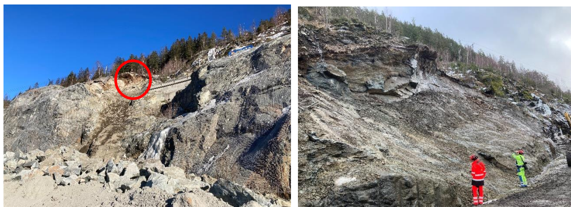
Figur 1-2. Bilder tatt etter skredet. Venstre foto (19.2): løснеområdet over lokalveien og nedrenskede masser liggende på E6. Høyre foto (25.2): Gjenstående parti etter nedstrossing og rensk ses øverst i bildet.
