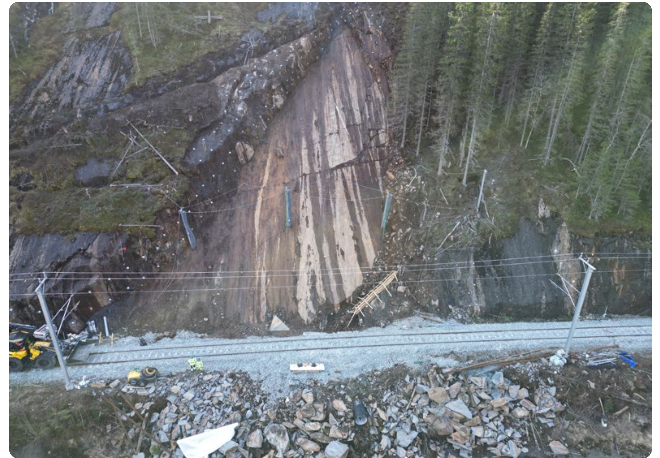
Tilstanden etter flere måneder med opprydningsarbeid og skredsikring.
