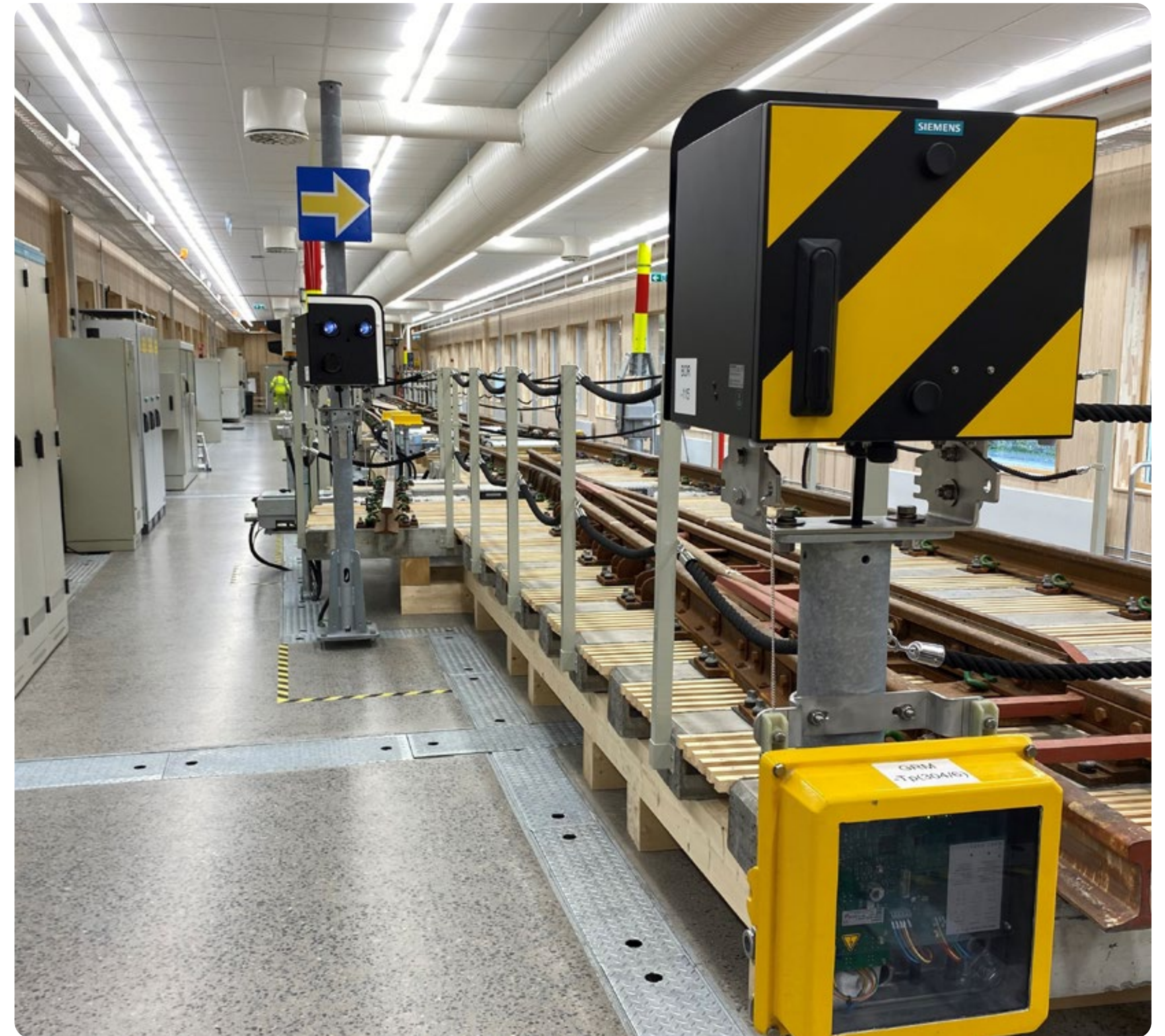
Øvingshall for nytt signalanlegg, ERTMS.
