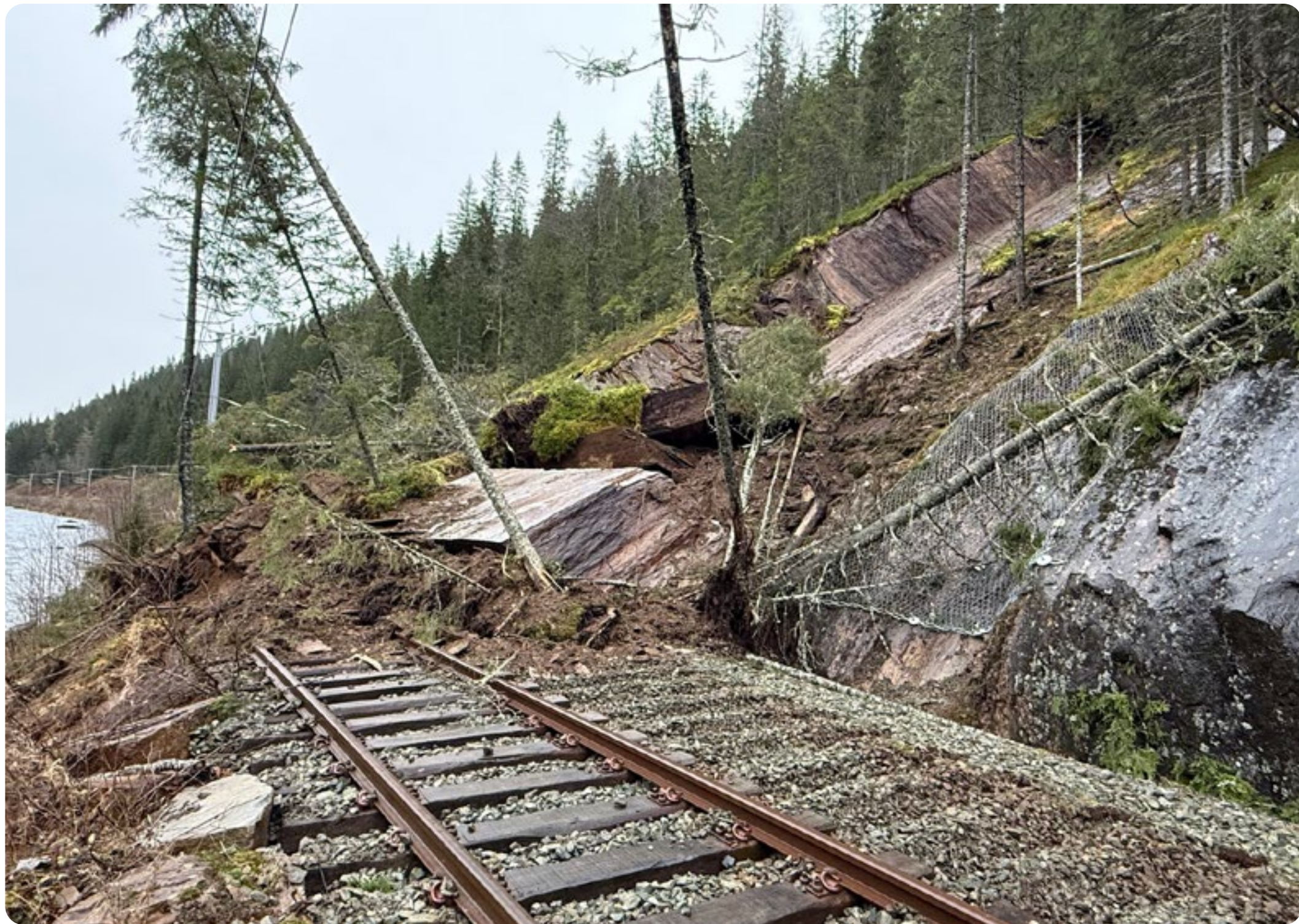
Skredet over Meråkerbanen.
