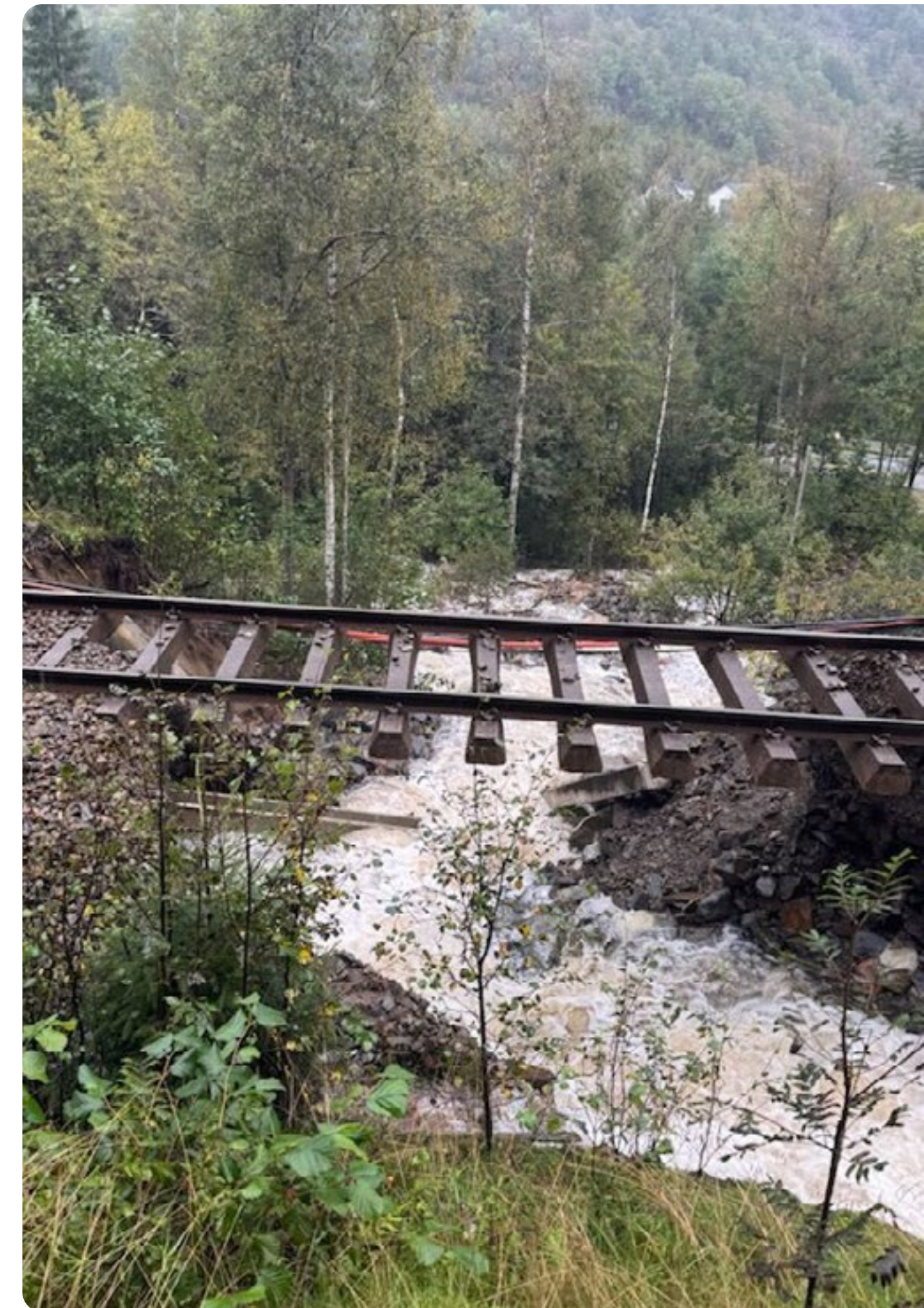
10-15 meter av grunnen under jernbanen ble vasket bort mellom Moi og Heskestad på Sørlandsbanen.
